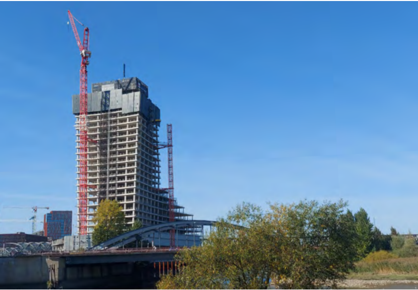
Aktuell gleicht der Elbtower eher einer Bauruine als einem eleganten Turm mit dem Potenzial als neues Wahrzeichen für Hamburg zu stehen. Foto: Grell
